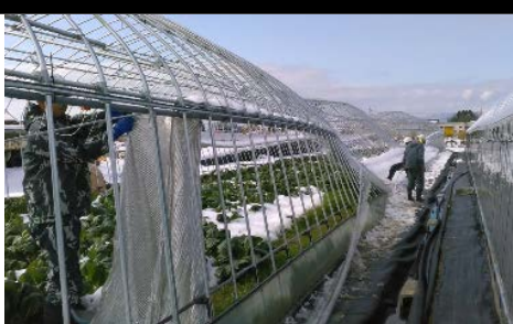
大雪により倒壊したハウス
